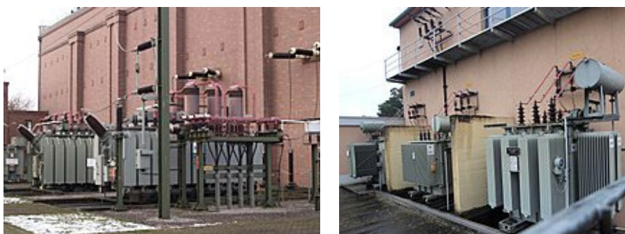
Slika 2.3. Trofazni uljni transformatori (distributivna mreža)
