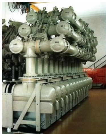
Slika 1.36. Izgled SF6 postrojenja (220 kV) za unutrašnju montažu
