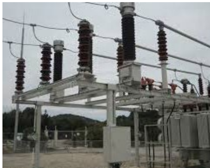
Slika 1.53. Odvodnici prenapona na ulasku u energetski transformator
