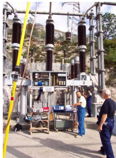
Slika 4.15. Dijagnostička ispitivanja visokonaponskih aparata i opreme na terenu
