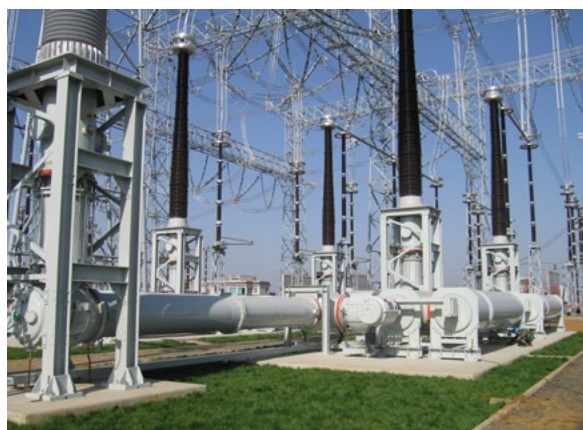
Slika 1.37. Izgled SF6 postrojenja (400 kV) za spoljašnju montažu
