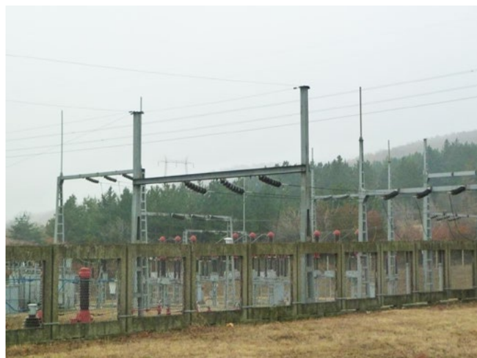
Slika 3.22. Zaštitna užad i štapne hvataljke u 110 kV postrojenju
