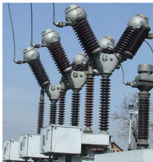
Slika 1.26. Malouljni prekidač (110 kV)
