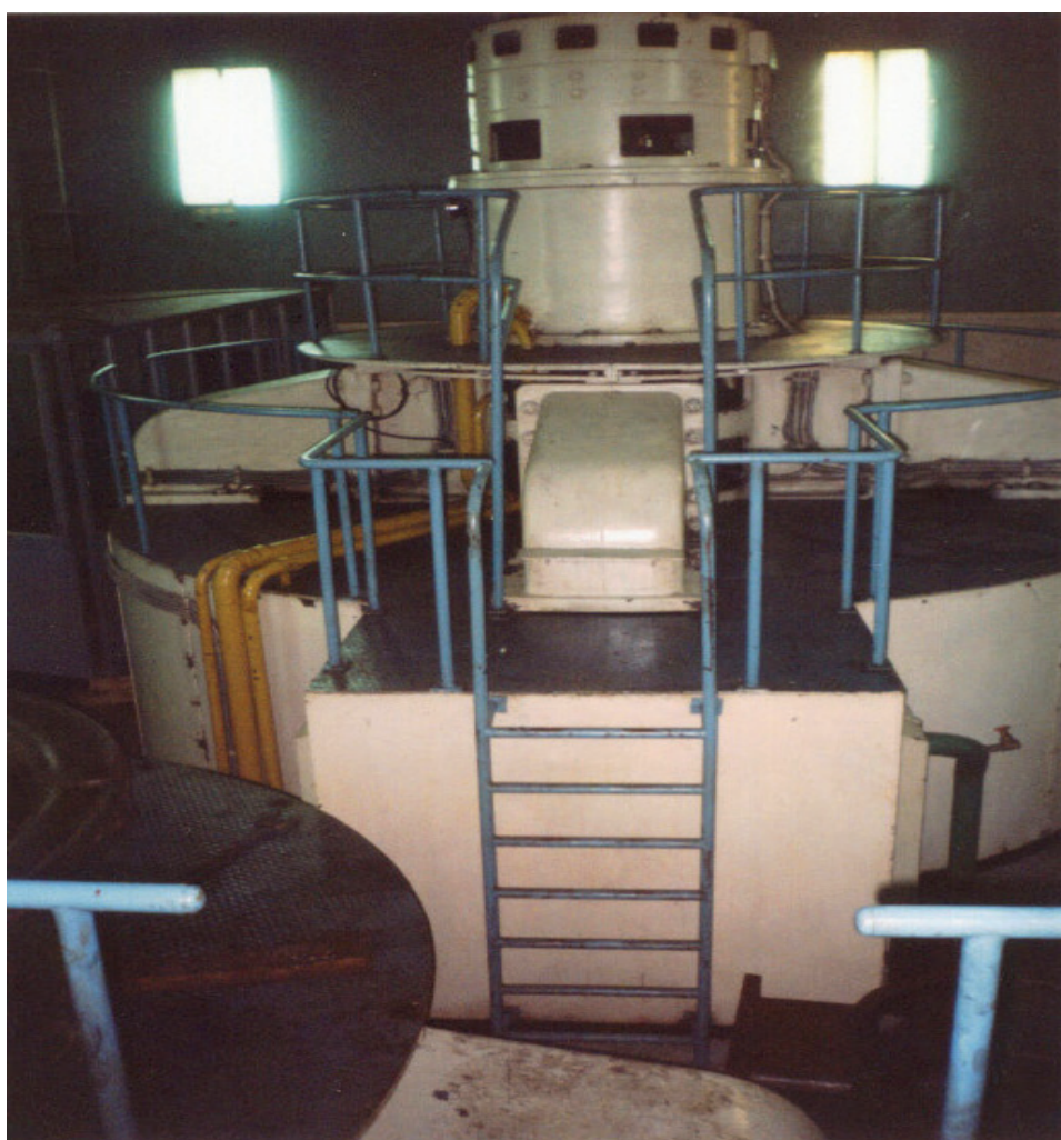
Slika 6.23. Unutrašnjost male hidroelektrane Glava Zete
