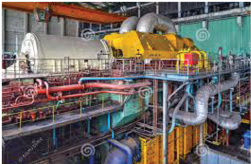
Slika 2.88. Mašinska zgrada parne termoelektrane
