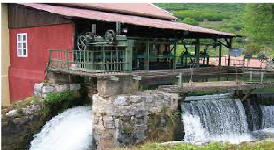
Slika 3.3. Mala hidroelektrana u pogonu
