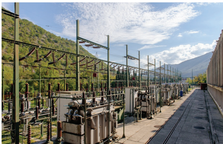
Slika 6.9. Visokonaponsko razvodno postrojenje HE Perućica
