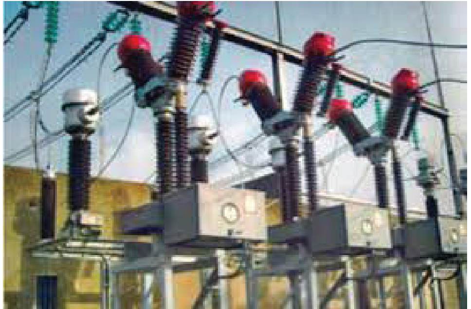
Slika 1.20. Dio visokonaponskog razvodnog postrojenja
